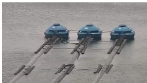
Figura 2 - Imagem do sistema de captação flutuante
