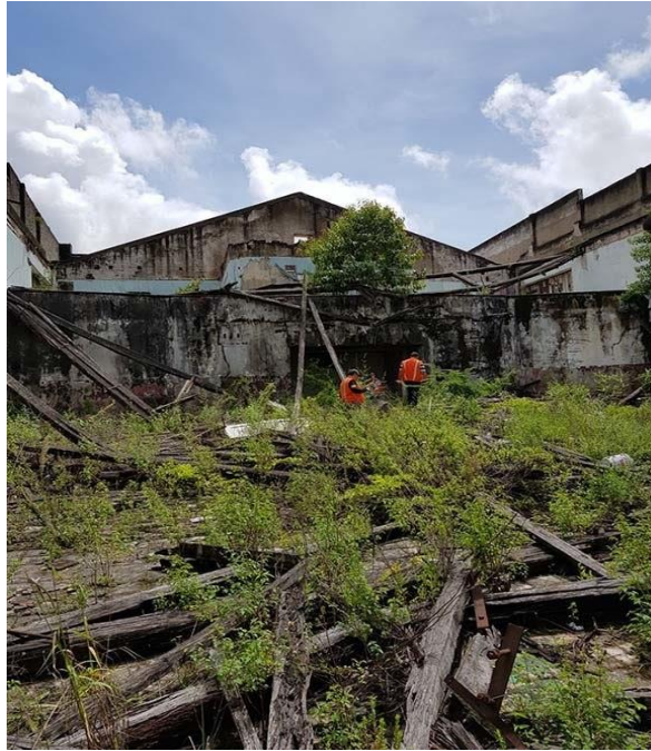
Figura 03: Imagem das ruínas do Cine Capitólio na inspeção da Defesa Civil
